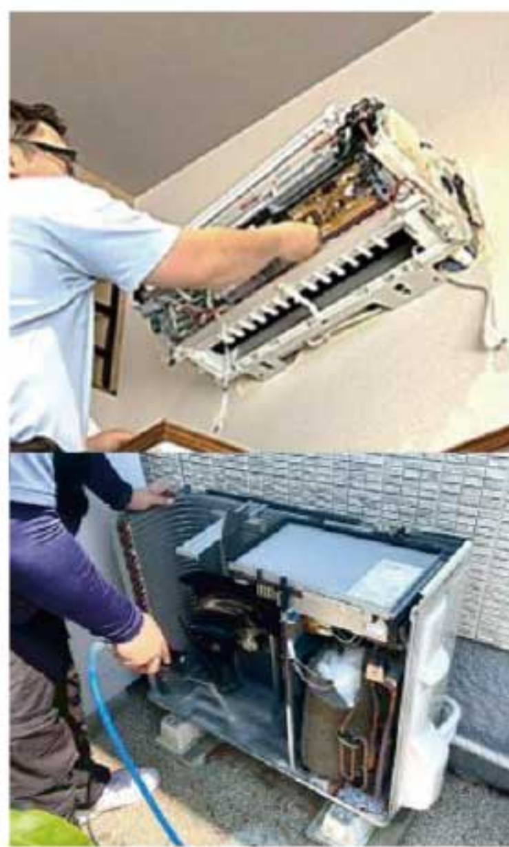
エアコン本体は分解して隅々まで、室外機もワンセットの徹底洗浄コースを早割対応出張・見積もりは無料
